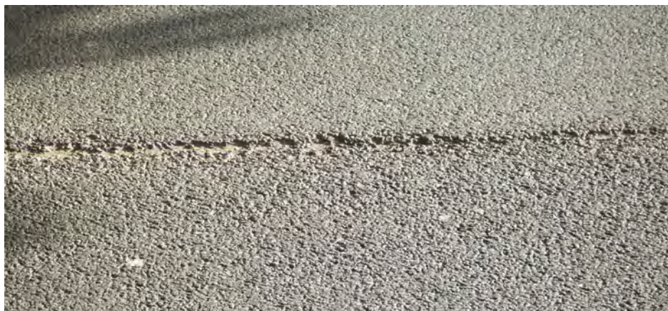
Teilstück der durchgängig mangelhaften Mittelnaht – hier kann Wasser eindringen und es entstehen danach Frostaufbrüche- wie lange soll nach Auffassung der Stadtverwaltung die viel befahrene Husemannstraße eigentlich halten?
